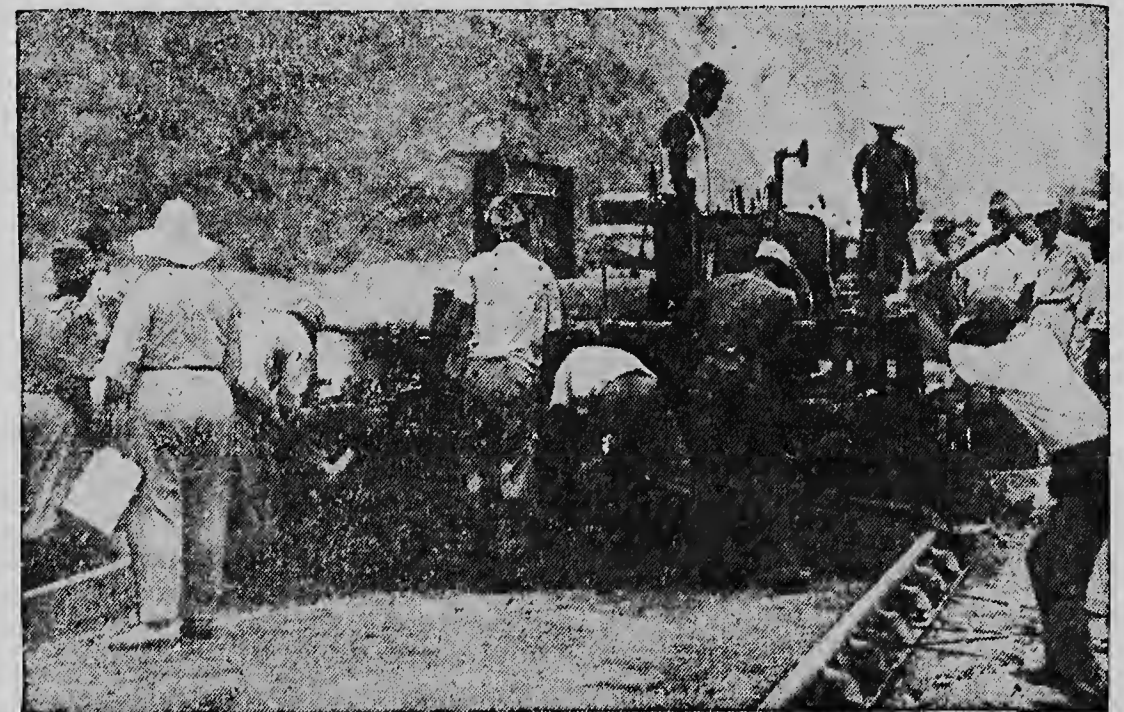
De laatste hand wordt gelegd. Arbeiders leggen de ruitering voor het betonnen wegdek.
